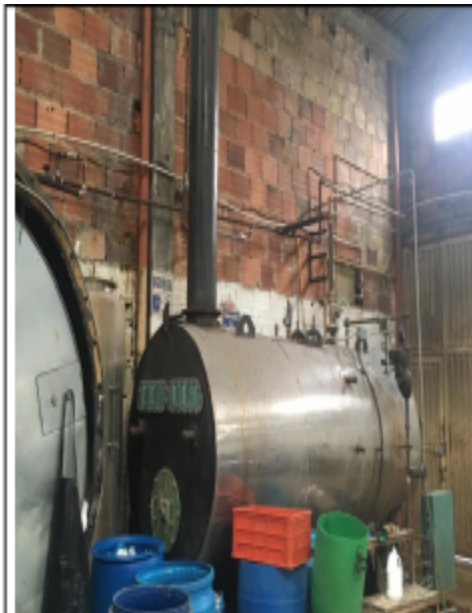
Fotografía No. 3 Caldera de 60 BHP que opera con gas natural
