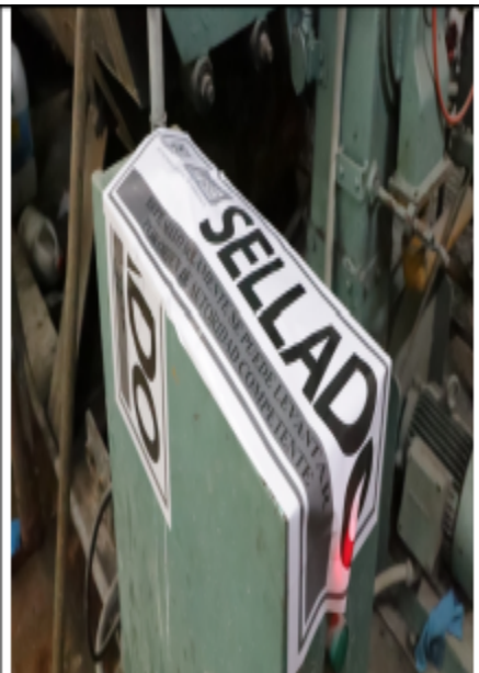
Fotografía No. 4 Imposición de sellos en la caldera de 60 BHP que opera con gas natural
